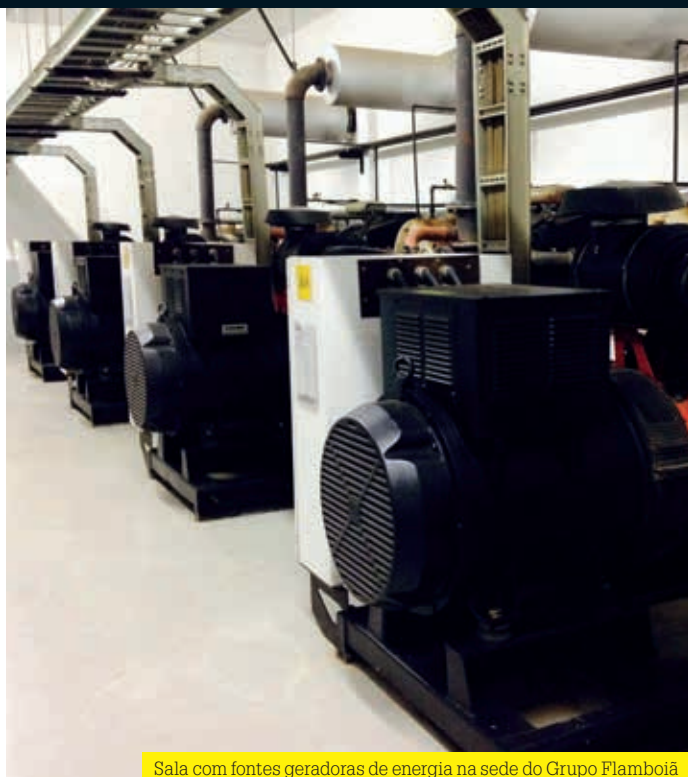
Sala com fontes geradoras de energia na sede do Grupo Flamboiã
